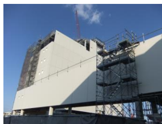
4号機燃料取出設備
